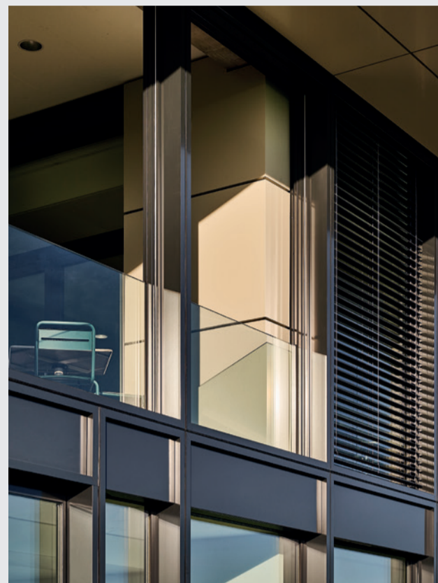
Bei der Loggia im ersten OG wurde zusätzlich ein Glasgeländer in die Fassadenelemente integriert.
